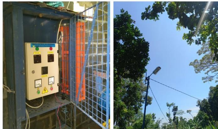
Gambar 4. Pembangkit Listrik Tenaga Mikrohidro dan Lampu penerang jalan Sumber: Dokumentasi Pribadi
